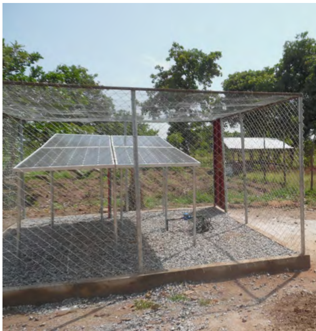
Il fotovoltaico per i pozzi.
